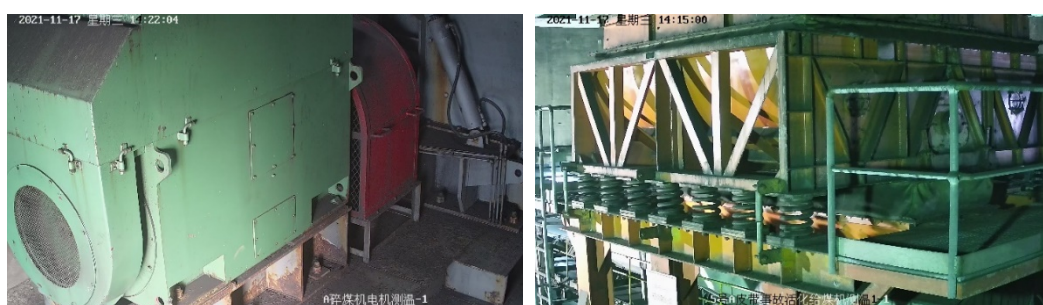
图18 碎煤机电机（左图），活化给煤机（右图）
